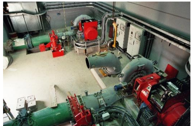
Fig. 7. Turbinage après-traitement : vue d'ensemble
