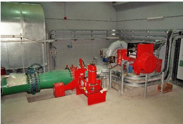
Fig. 6. Turbinage après-traitement : turbine Francis
