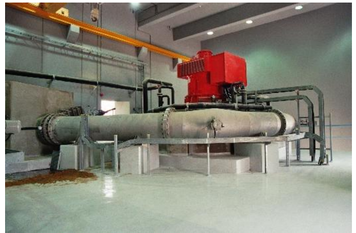
Fig. 2. As Samra : turbine Pelton pendant la mise en service sur site
