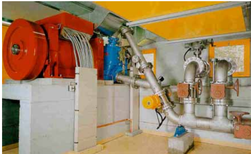
Intérieur de la petite centrale hydroélectrique de la STEP du Châble
