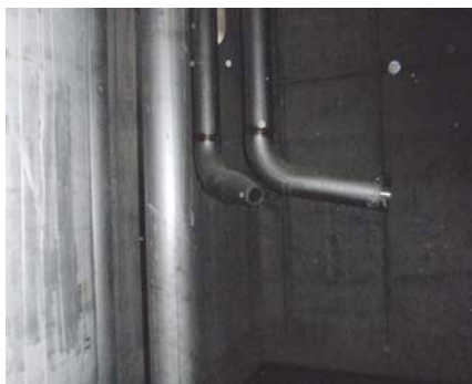
Figure 6. Le by-pass du turbogroupe de SITSE dans le réservoir aval (vidé): le tube de Carnot, les deux tubes des tuyères et les 2 tuyères équipées de vanne (Source : Mhylab)
