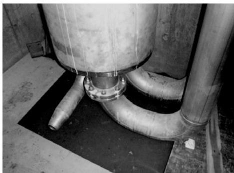
Figure 5. Le by-pass du turbogroupe de SITSE au niveau du réservoir aval (vidé): la fin du tube de Carnot, le départ des 3 tuyères dont la plus petite, toujours ouverte (Source : Mhylab)
