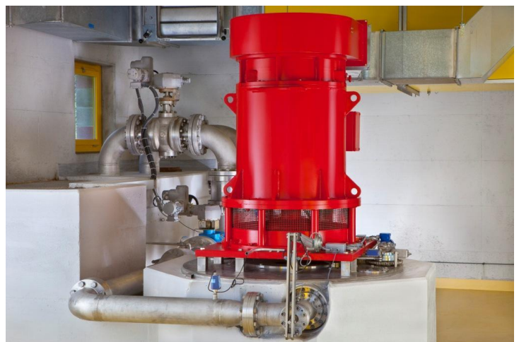
Figure 22. Turbine Pelton du Profray (Le Châble, Valais, CH) conçue sur la base de la systématisation, exploitant les eaux usées brutes de Verbier ( Q_n = 0.10 \text{ m}^3/\text{s} , \Delta Z = 449 \text{ m} , P_e = 380 \text{ kW} , 850'000 \text{ kWh}/\text{an} , soit de l'électricité pour 190 ménages) [5] (© Mhylab)
