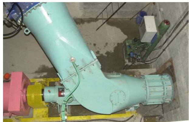
Figure 8. Nouveau groupe axial de St-Bueil: turbogénérateur de 345 kW
