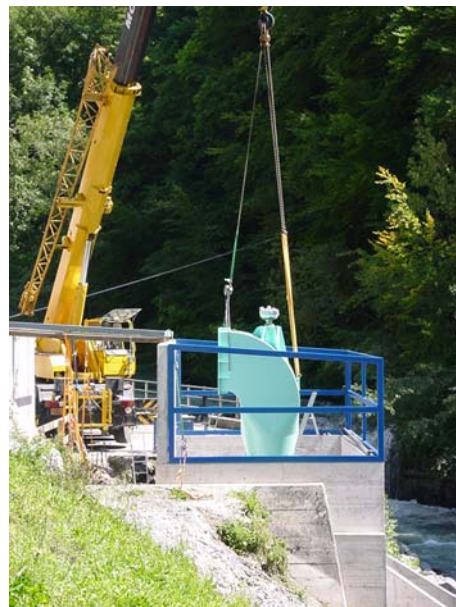
Figure 4. Implantation de la petite turbine des Farettes
