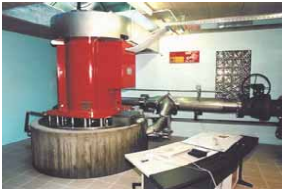
Fig 5 Petite turbine Pelton de la centrale de La Rasse, 2 injecteurs, 753 kW
