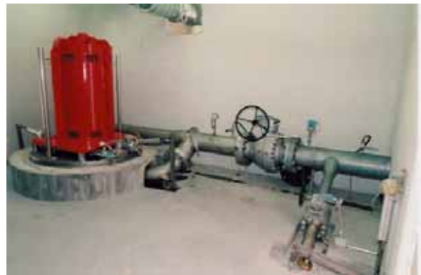
Fig6 Petite turbine Pelton de la centrale de Pas-du-Lein, 2 injecteurs, 470 kW
